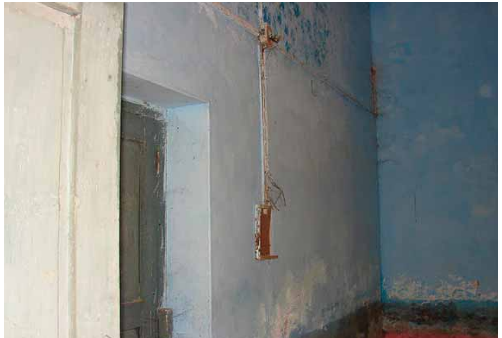
▣ Beschädigungen im Inneren des Gebäudes: Stromkabel liegen frei, der Putz bröckelt.
