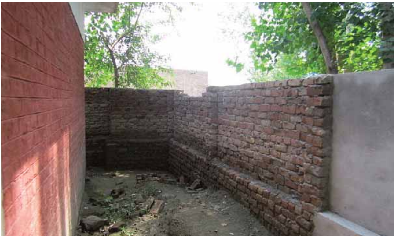
▣ Außenwand der Schule und Schulmauer. Auch hier sind die Spuren der Flut noch deutlich sichtbar.
