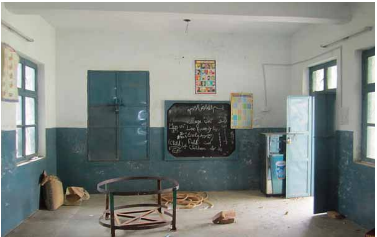
■ Leeres Klassenzimmer der Schule. Die vom Wasser zerstörten Möbel wurden bereits entsorgt.
